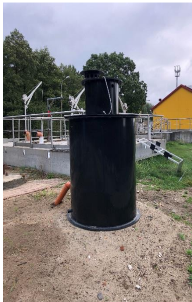
Fot. 10. Biofiltr do dezodoryzacji powietrza złownnego komory uśredniania ścieków surowych.
