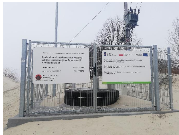
Fot. 18. Przepompownia ścieków przy ulicy Bursztynowej
