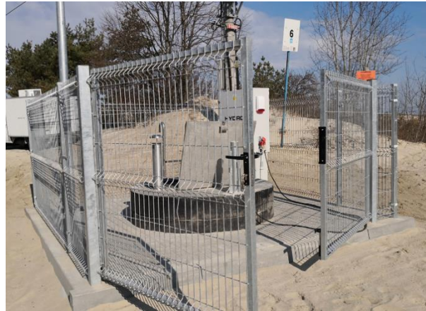
Fot. 17. Przepompownia ścieków przy ulicy Bursztynowej
